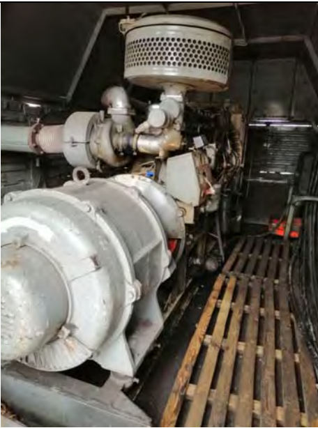
Фото існуючої дизельної електростанції (вид зсередини)
