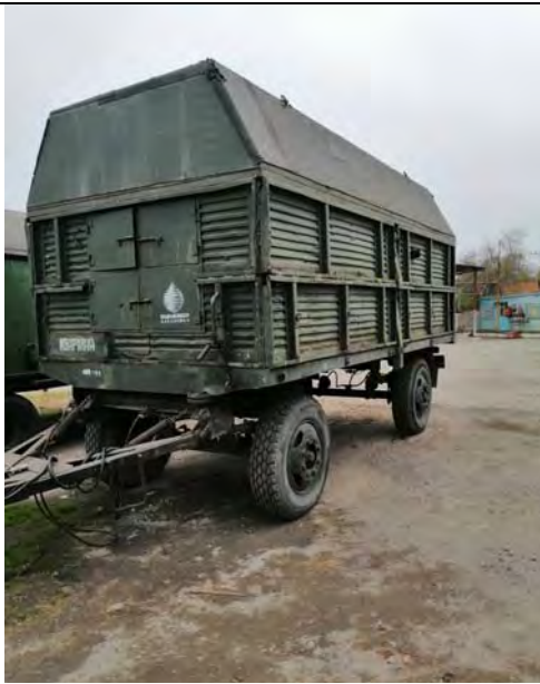
Фото існуючої дизельної електростанції (вид зовні)
